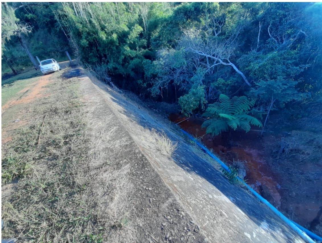
Figura 7.4 – Vista da condição do talude de jusante da barragem Passa Cinco em maio de 2021. Surgência com carreamento de sólidos (visto água turva observada) possivelmente no contato ombreira direita e barramento. Também verifica-se a presença de árvores e bambuzal de grande porte nas ombreiras.
