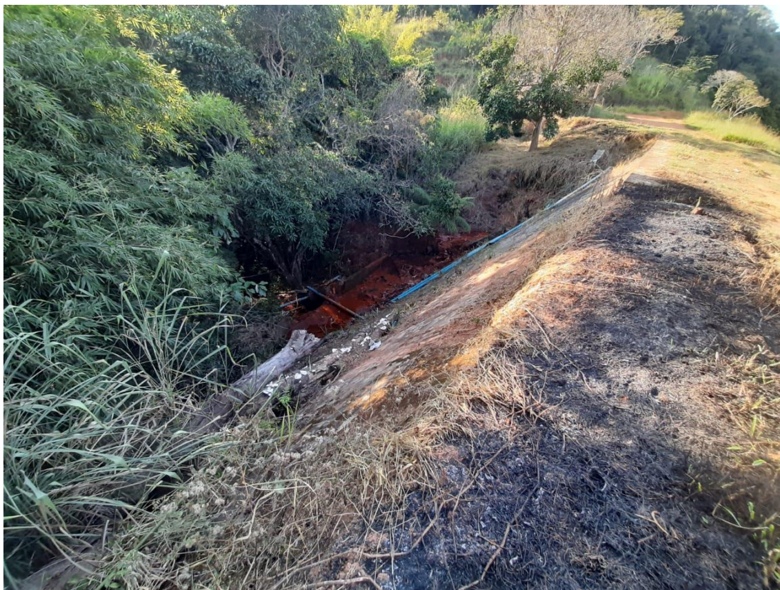
Figura 7.3 – Vista da condição do talude de jusante da barragem Passa Cinco em maio de 2021. Surgência com carreamento de sólidos (visto água turva observada) possivelmente no contato ombreira direita e barramento.
