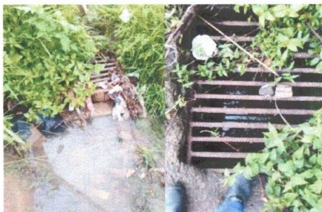
Figura 4: Bueiros Entupidos na Rua João Evangelista de Almeida
