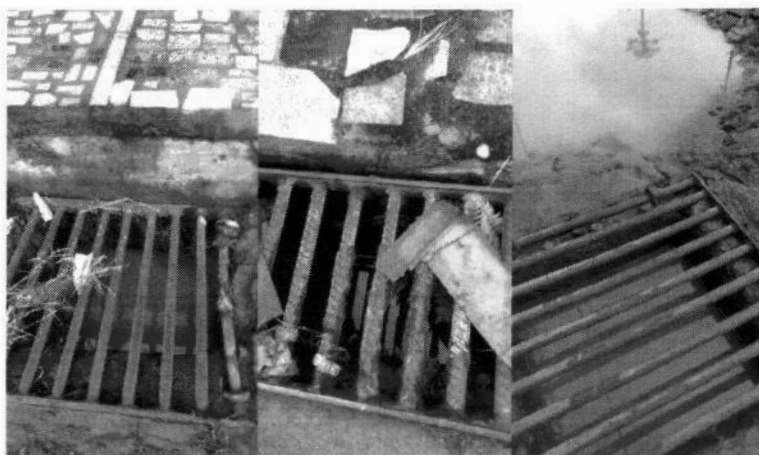
Figura 3: Bueiros Entupidos na Rua Independência, Vila Centenário
