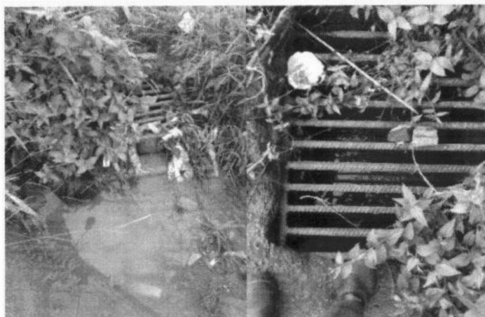
Figura 4: Bueiros Entupidos na Rua João Evangelista de Almeida
