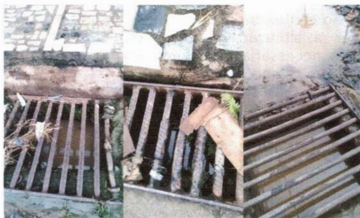
Figura 3: Bueiros Entupidos na Rua Independência, Vila Centenário
