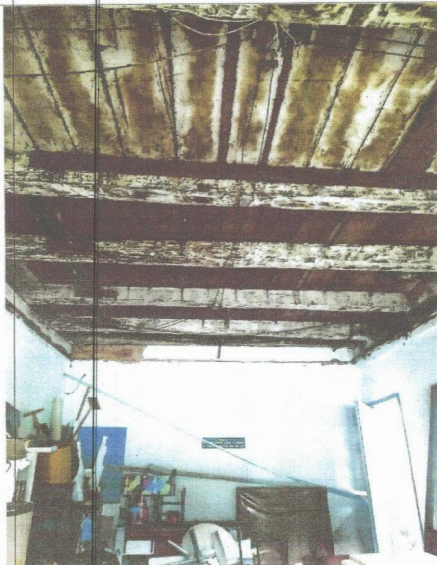
Foto 23: piso madeira vista inferior - 24/05/2021
