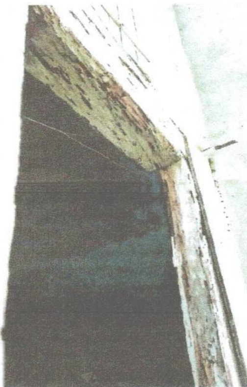
Foto 10: marco porta externa comprometido por ataque de cupim - 24/05/2021
