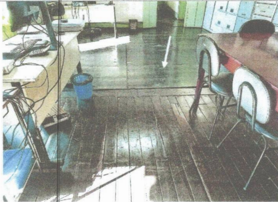
Foto 19: piso madeira – proteção paliativa - 24/05/2021
