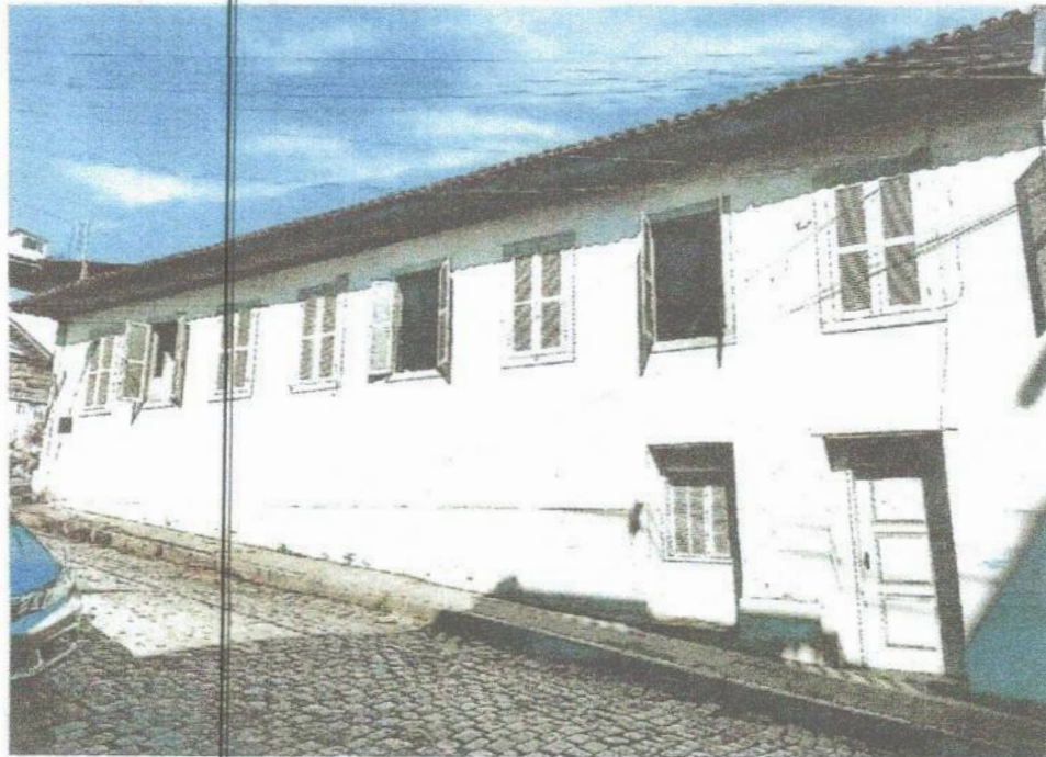
Foto 14: telhado faltando cimalha na fachada frontal - 24/05/2021
