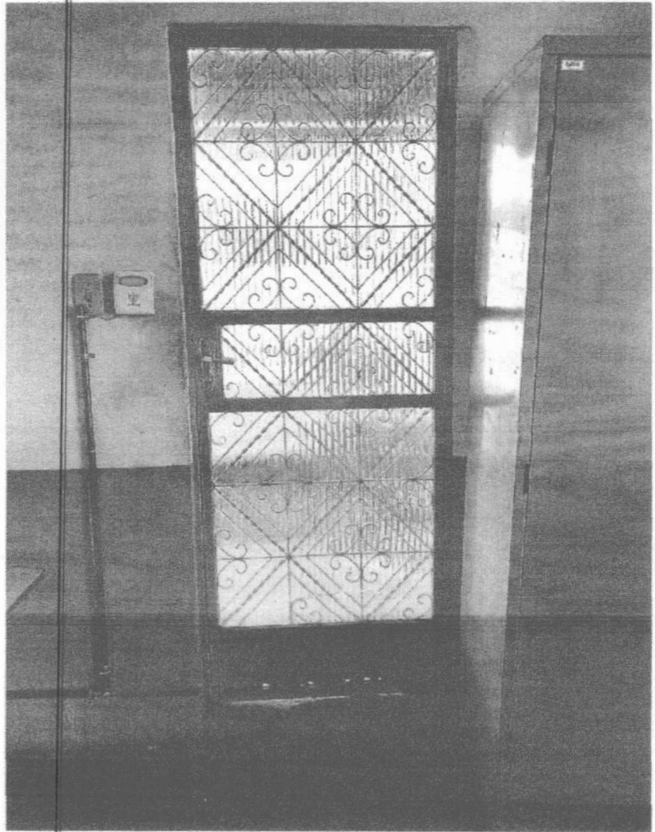
Foto 08: porta com estrutura corroída - 24/05/2021
