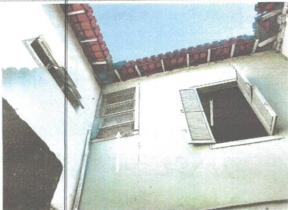
Fotc 09: janela sem vidro - 24/05/2021
