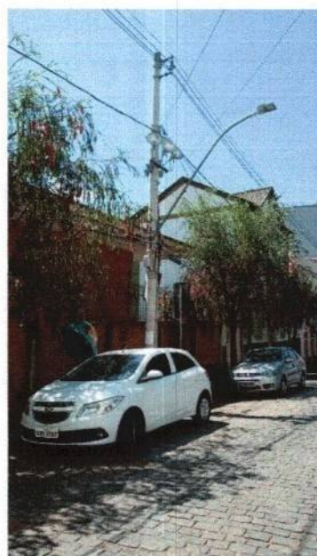
FOTO 28 – Poste de fundo Igreja Matriz São Sebastião, 1 Pétales de led , 3 Refletores com reator (Poste P9)
