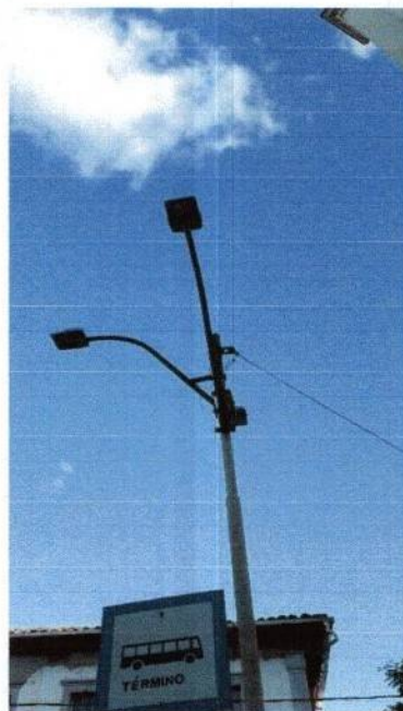
FOTO 2 – Poste frontal, 3 Pétalas, Lâmpada de Led. Chegada de cabos Alimentação vem do P5. Foto retirada abaixo por baixo P6(ver Projeto).
