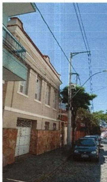
FOTO 12 – Poste Lateral Direita, 1 Pétala de led , 2 Refletores com reator (Poste P4)
