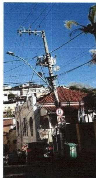
FOTO 18 – Poste de fundo, 1 Pétales de led , 2 Refletores com reator (Poste P1)
