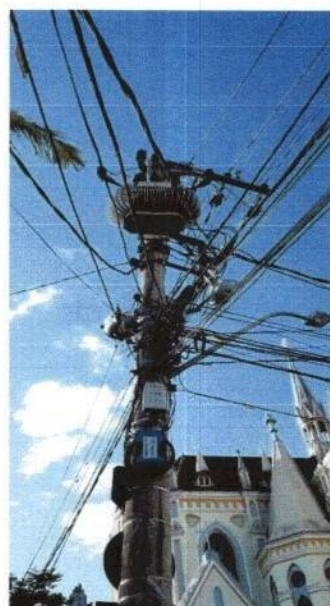
FOTO 20 – Poste de fundo Igreja Matriz São Sebastião, 1 Pétales , 2 Refletores (Poste P1)
