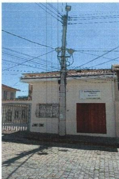
FOTO 13 – Poste Lateral Direita a Igreja Matriz São Sebastião, 1 Pétala de led, 2 Refletores com reator (Poste P3)
