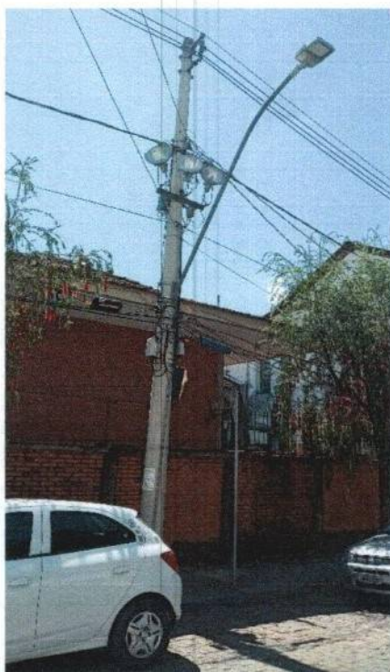
FOTO 29 – Poste de fundo Igreja Matriz São Sebastião, 1 Pétalas de led , 3 Refletores com reator (Poste P9)
