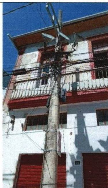
FOTO 26 – Poste de fundo Igreja Matriz São Sebastião, 1 Pétales de led , 3 Refletores com reator (Poste P8)
