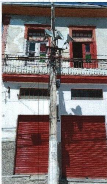
FOTO 25 – Poste de fundo Igreja Matriz São Sebastião, 1 Pétales de led , 3 Refletores com reator (Poste P8)
