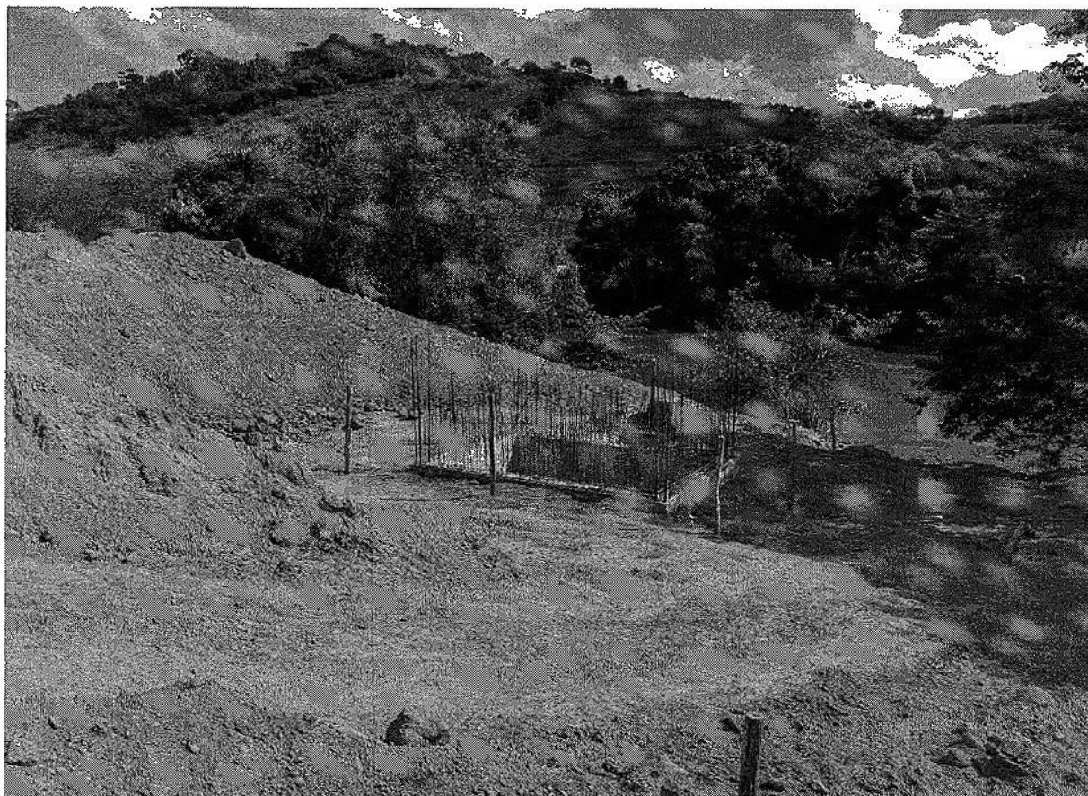
Figura 3: Estação elevatória margem direita
