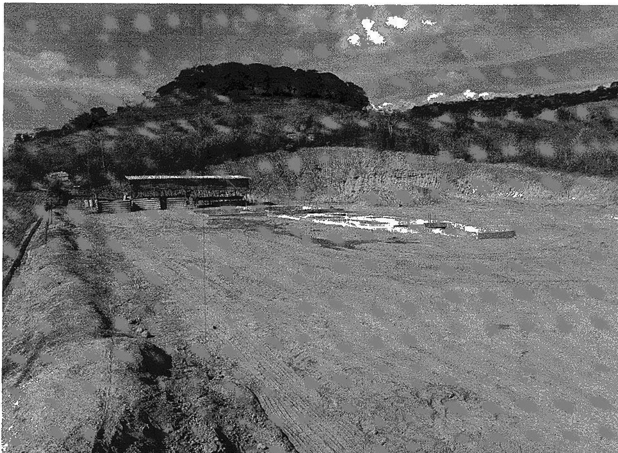
Figura 9: Tratamento preliminar estação de tratamento de esgoto
