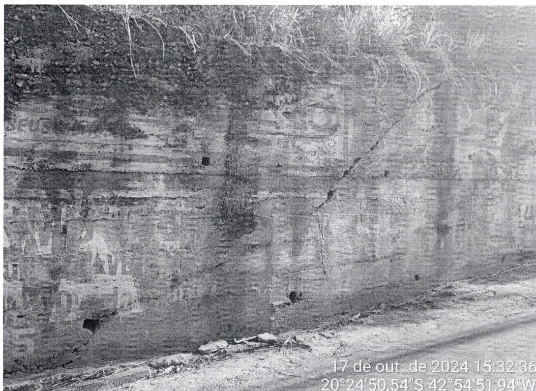
Figura 2: Rachadura no muro
