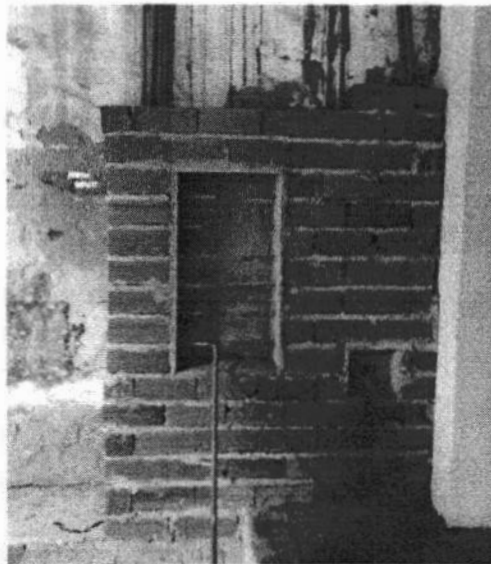
CAVALETE HIDRÁULICO / ABRIGO TORNEIRA
