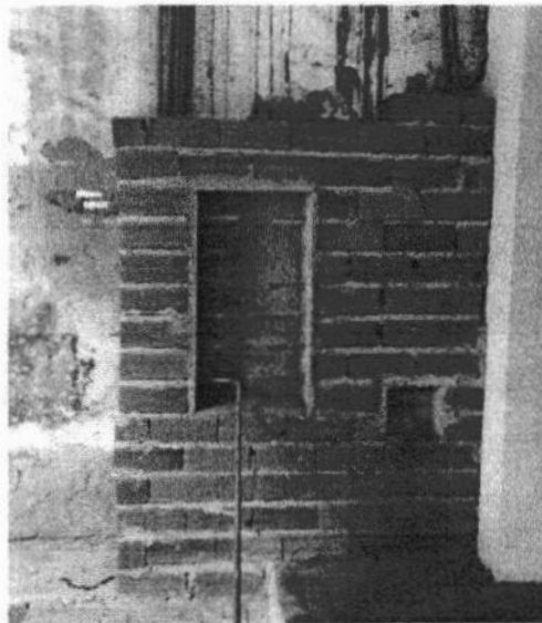
CAVALETE HIDRÁULICO / ABRIGO TORNEIRA
