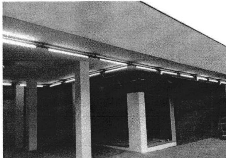
LUMINÁRIAS / PINTURA ACRILICA / TEXTURA / SUPORTE LETREIRO
