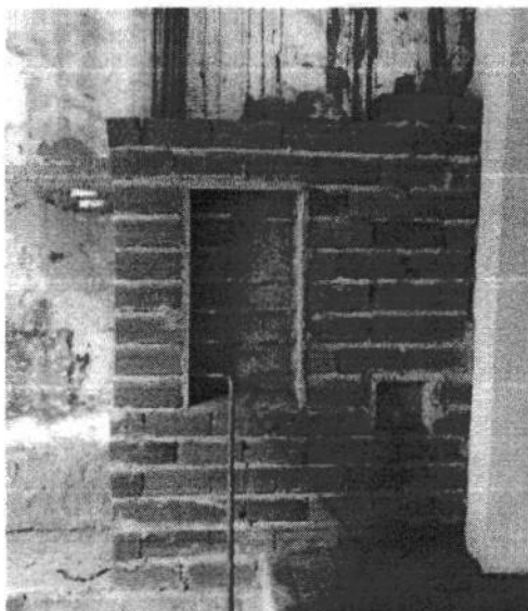
CAVALETE HIDRÁULICO / ABRIGO TORNEIRA
