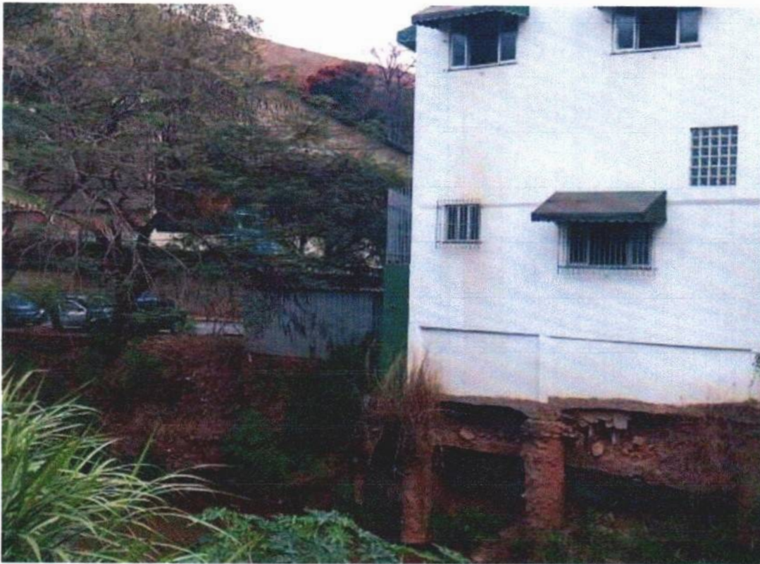
Figura 10: Destaque fundação exposta
